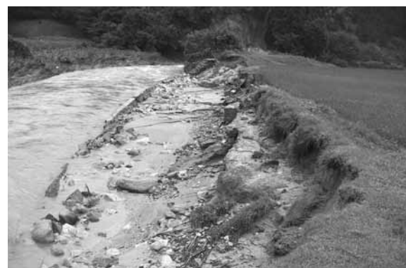
城原川の護岸被災状況
