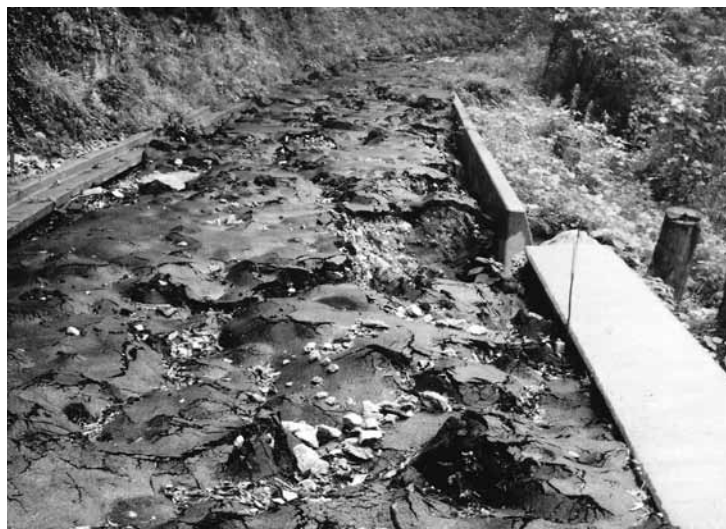
舗装が割れ、浮き上がった状況
