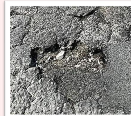
道路破損の報告
