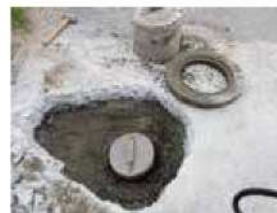
埋められた公共マス
