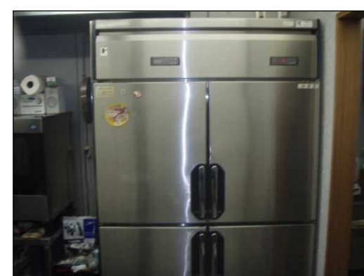
3 5 冷凍冷蔵庫 × 1 (厨房)
