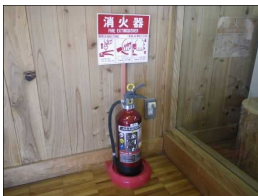
5 1 消火器 × 2 (レストラン・厨房)
