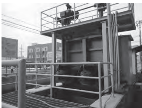
排水設備のゲートポンプ
