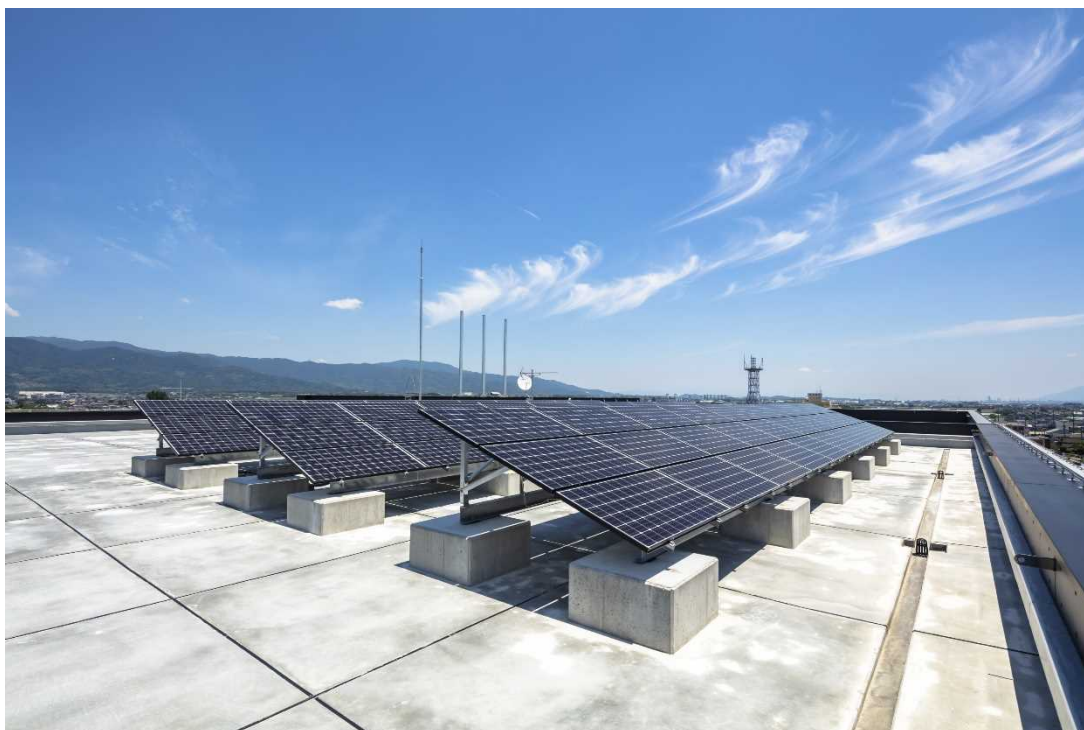
写真-1.1 市役所屋上の太陽光パネル
