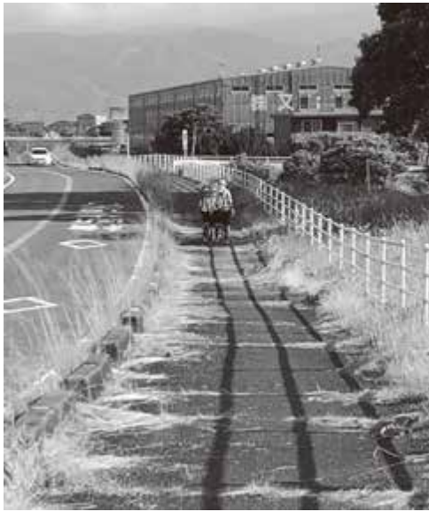
雑草が繁茂する歩道
