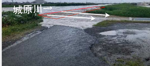
9号野越しの越水状況 (7/10 6時頃)
