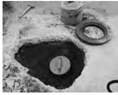
▲埋められた公共マス
