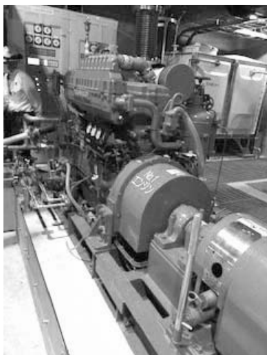
新設更新された江見排水機場内部
