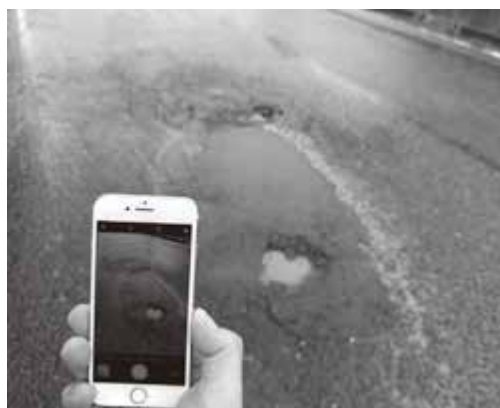
道路の損傷を通報するイメージ
