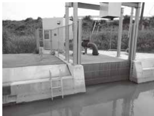
お隣の大川市独自で設置し稼働している 道海島地区の排水ポンプ場
