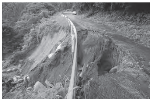
脊振町東鹿路地区の被害状況
