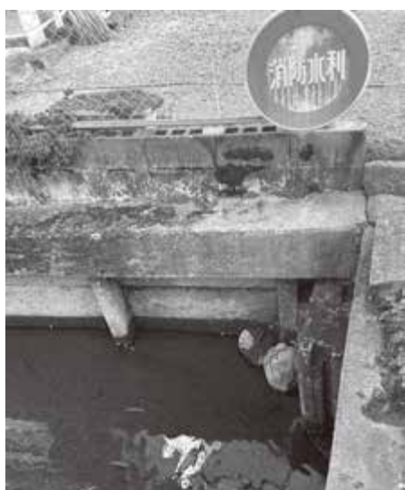
消防水利標識も薄れ、水量・水深の確保と整備をお願いする
