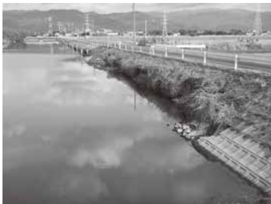
経年劣化で法落ちが進んでいる大詫間幹線水路
